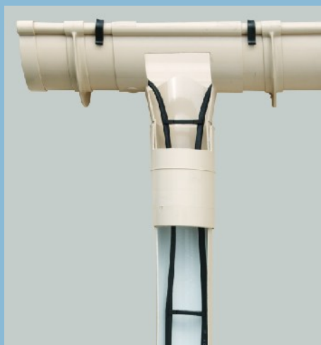
Mocowanie przewodów grzejących w rurze spustowej przy pomocy uchwytów
